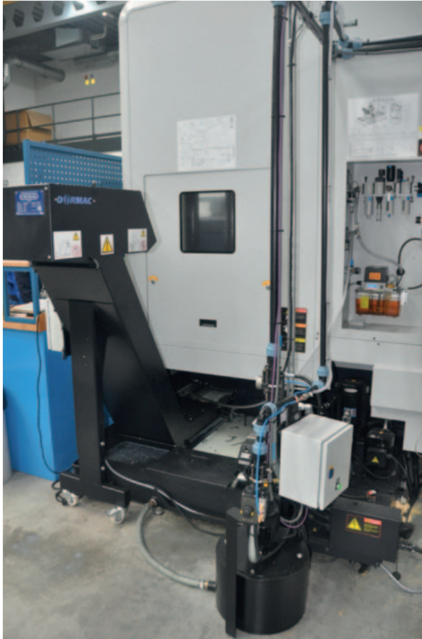
Substation (bij een van de acht aangesloten CNC-machines) voert vervuilde koelvloeistof af naar de centrale tank en brengt gezuiverde koelvloeistof uit de centrale tank de CNC-machine in.
