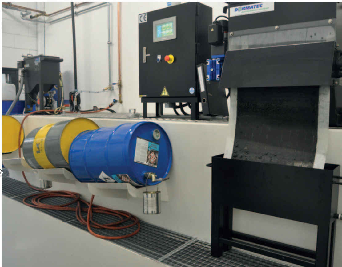
De 5.000 liter grote, centrale filtertank (de witte bak) met compact bandfilter (rechts) en olieafscheider (links op de tank); dit alles aangestuurd via de masterbesturing (midden).
