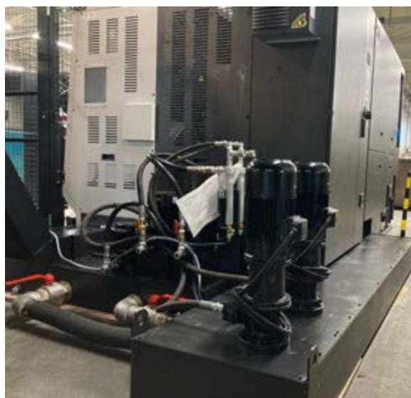
Hogedrukkoeling en een filterinstallatie voor het koelsmeerbaddragen bij aan een hogere processtabiliteit, een van de eisen die HFI vooraf aan de oplossingen stelde.
